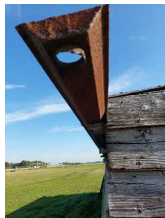
Fotonummer: 12 Omschrijving: Uiteinde goot aan zuidwestkant asbestverdachte dak (foto richting noordoost)
