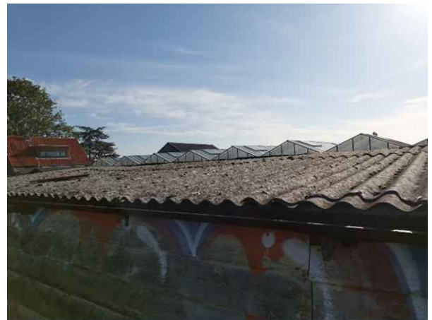
Fotonummer: 10 Omschrijving: Dak met asbestverdachte golfplaten bij 4903-nen
